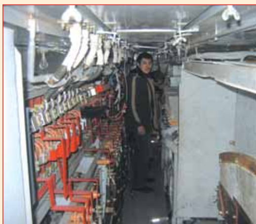
Рис. 2. Внутренний вид секции локомотива
