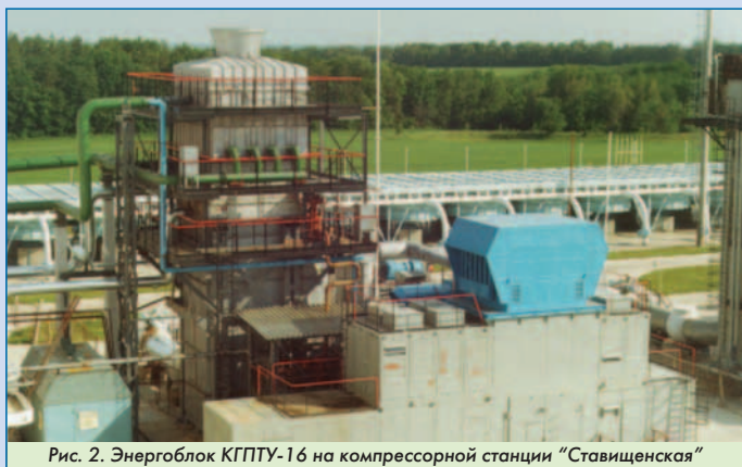
Рис. 2. Энергоблок КГПТУ-16 на компрессорной станции "Ставищенская"
