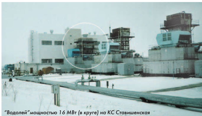
“Водолей” мощностью 16 МВт (в круге) на КС Ставишская
