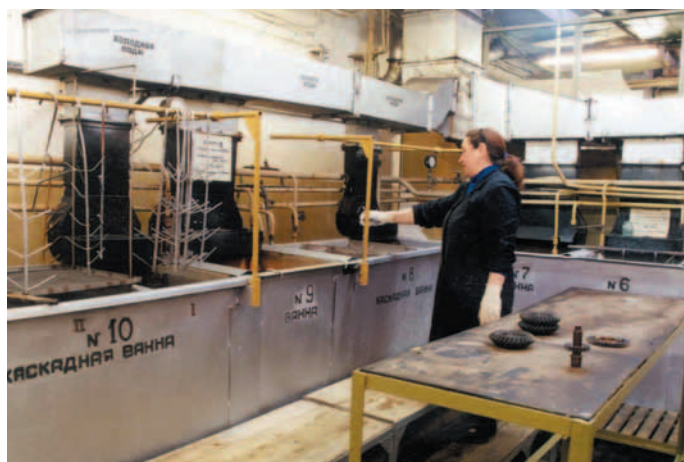
Установка малосточной системы оксидофосфатирования и хромовокислой обработки углеродистых сталей
