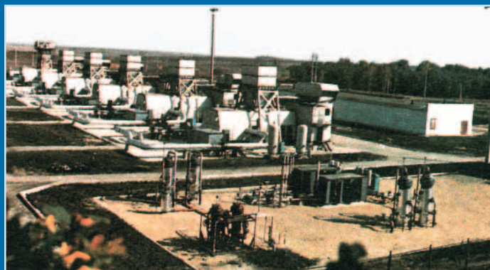
Компрессорная станция с НК-16СТ
